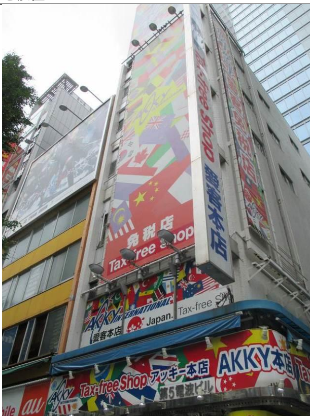
道路に突出した袖看板や1階看板は越境していたため除却した。
