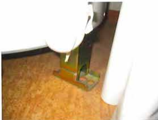
写真2 固定が何もされていない事例。 電気温水器の耐用年数は15年程度といわれている。 リフォーム業者がボルト締めを行わないで設置して しまったらしい。
