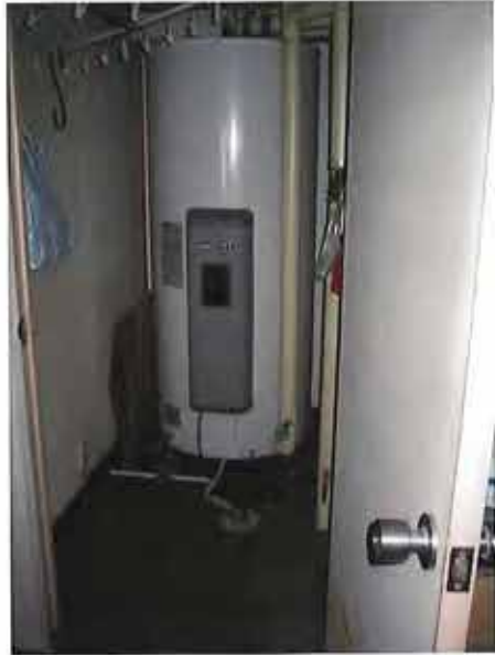
写真1 フローリングの上に置かれた電気温水器。 フローリングは構造躯体ではないので 設置強度が取れない。 地震時に転倒する恐れがある。
