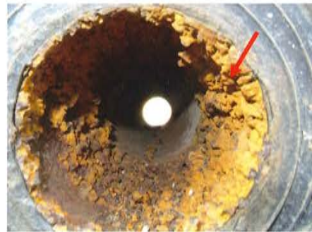
給水管内錆発生
