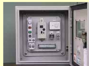
感震器内蔵制御盤
