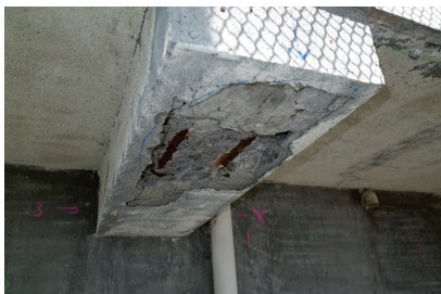
鉄筋の腐食、爆裂
