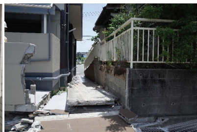
ブロック塀が倒壊したマンション
