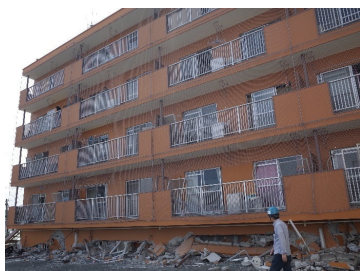
1階部分が圧壊したマンション
