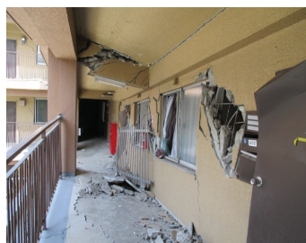
大破したマンションの共用廊下
