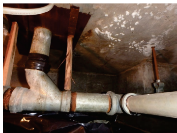
排水設備や浴室防水からの漏水
