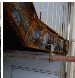
鉄骨階段支持部材の腐食
