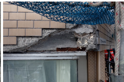
サッシ周囲の詰めモルタル不良
