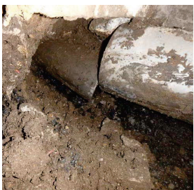
排水管の破損による漏水
