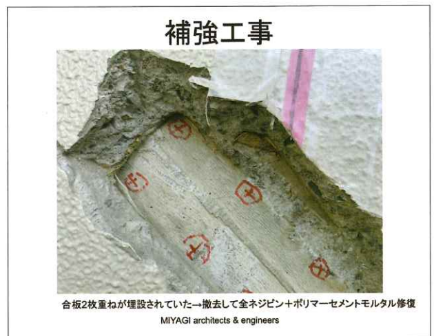
図 14 合板 2 枚重ねの埋設物撤去と全ネジピン + ポリマーセメントモルタル修復
