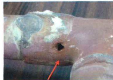
漏水の原因となったピンホール
