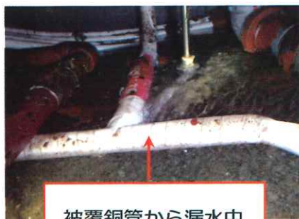
被覆銅管から漏水中
