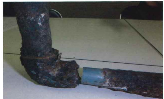
写真1 築33年、トイレのロータンクに接続される専有部分給水管の立ち上がり部分の激しい腐食事例。
