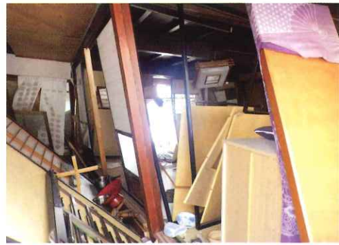
写真 11 輪島市河井地区
