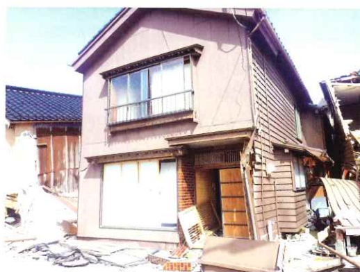
写真6 輪島市河井地区
