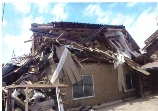
写真 1 輪島市河井地区
