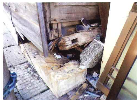
写真 15 輪島市河井地区
