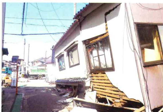
写真4 輪島市河井地区
