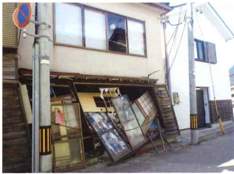
写真 10 輪島市河井地区
