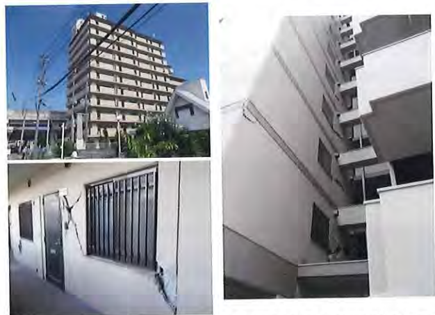
写真10 新耐震基準建築物②。共用廊下の雑壁にひび割れを確認したが、主要構造部(柱・梁)に被害は確認されない。本建物居住者は全員退避していた。
