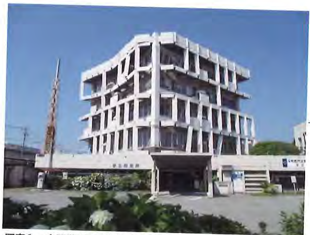
写真1 中間階が大破した宇土市役所。1年後の調査時には更地となり、役所機能は仮庁舎に移されていた。
