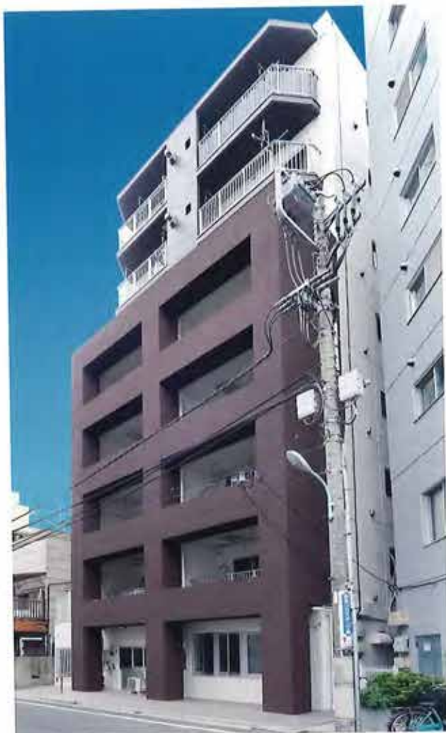
写真2 改修後 外付けフレームと耐震スリットによる補強工事、及び大規模修繕工事が完了
