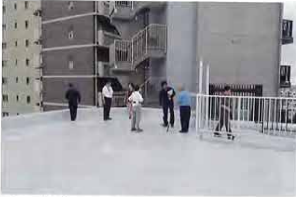
写真7 自主管理組合による完了検査 完了後、自主管理組合が工事完了のチェックを行い、引き渡しを受ける
