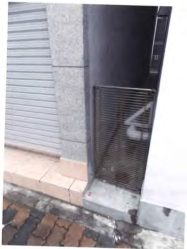
幹線道路沿いのマンション 建物の道路後退距離がほとんどなく、隣棟間隔も50cm程度 敷地に余裕がないため、建物外側での補強ができない
