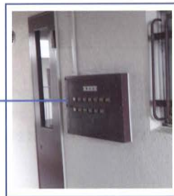
各階に設置された警報盤 (発報された住戸を表示)
