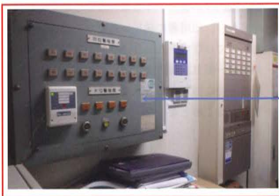
管理室の防犯警報盤 (発報された階を表示)
