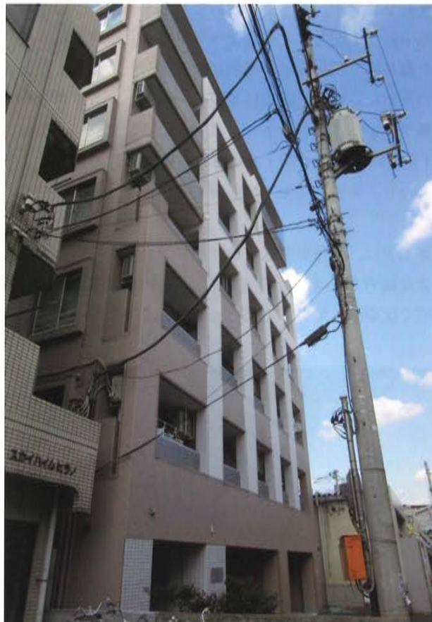
改修後南面外観 隣地境界上の危険なコンクリートブロック塀は 上段を撤去し安全な高さに
