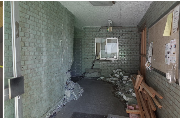
エントランス避難経路に落下した仕上材
