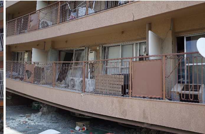
1階部分圧壊し、2階から上の住戸にも被害
