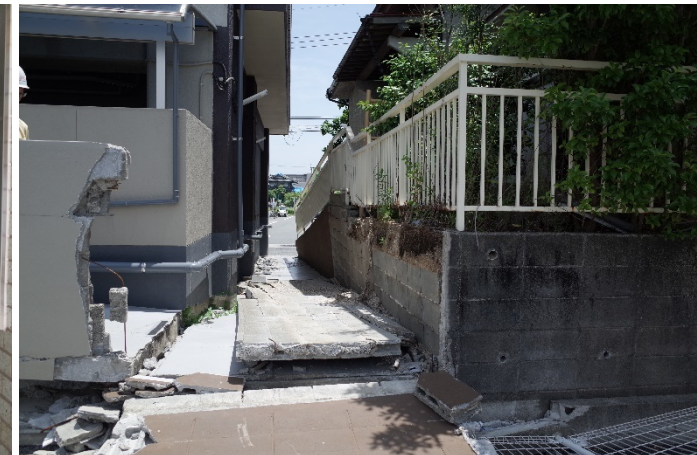
ブロック塀が倒壊したマンション
