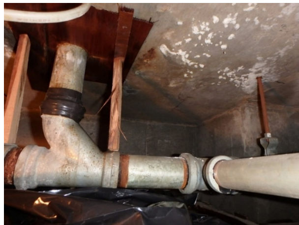
排水設備や浴室防水からの漏水
