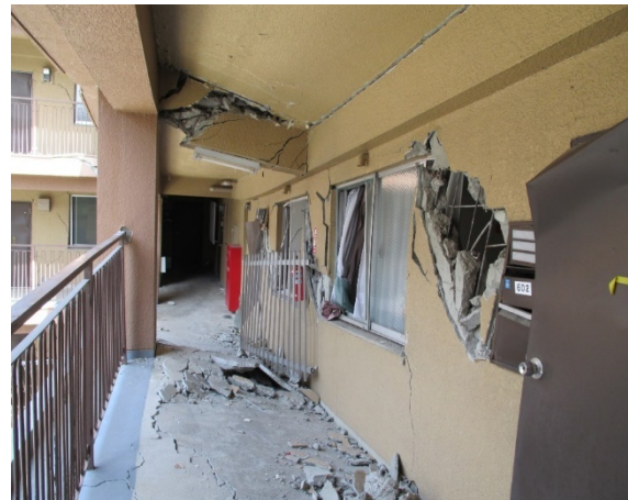
大破したマンションの共用廊下
