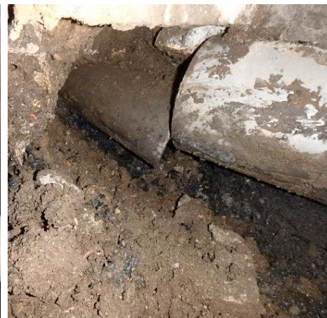
排水管の破損による漏水
