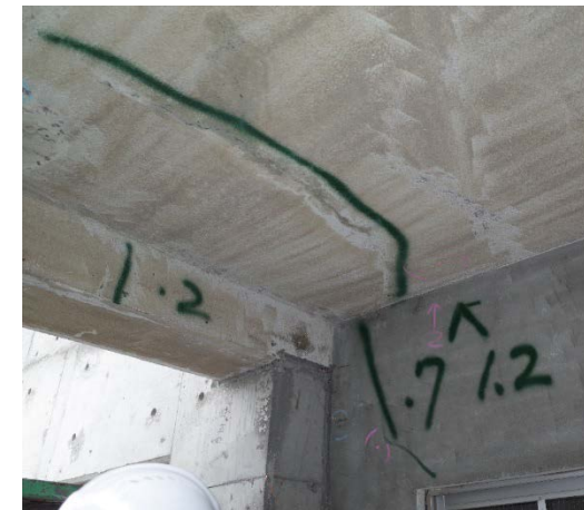
コンクリート躯体のひび割れや中性化
