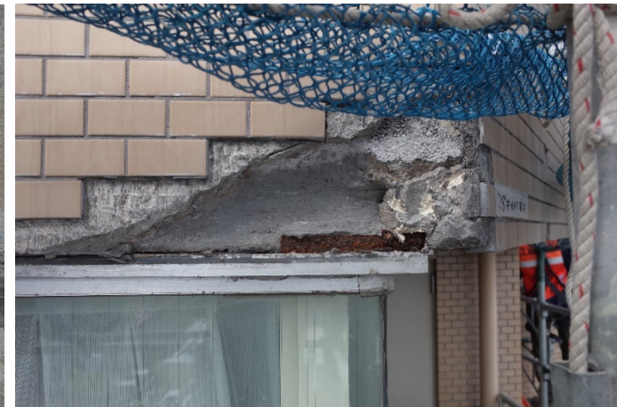
サッシ周囲の詰めモルタル不良
