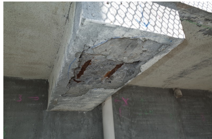
鉄筋の腐食、爆裂
