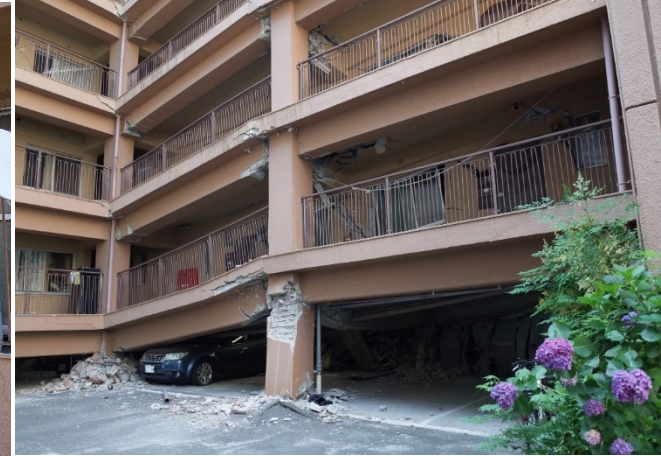
1階ピロティ駐車場が圧壊したマンション
