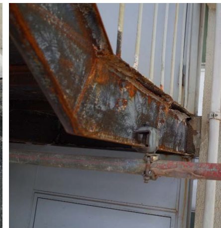
鉄骨階段支持部材の腐食
